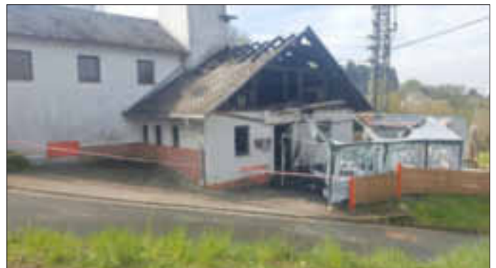
Komplette Zerstörung durch den Brand. Foto: kpw
